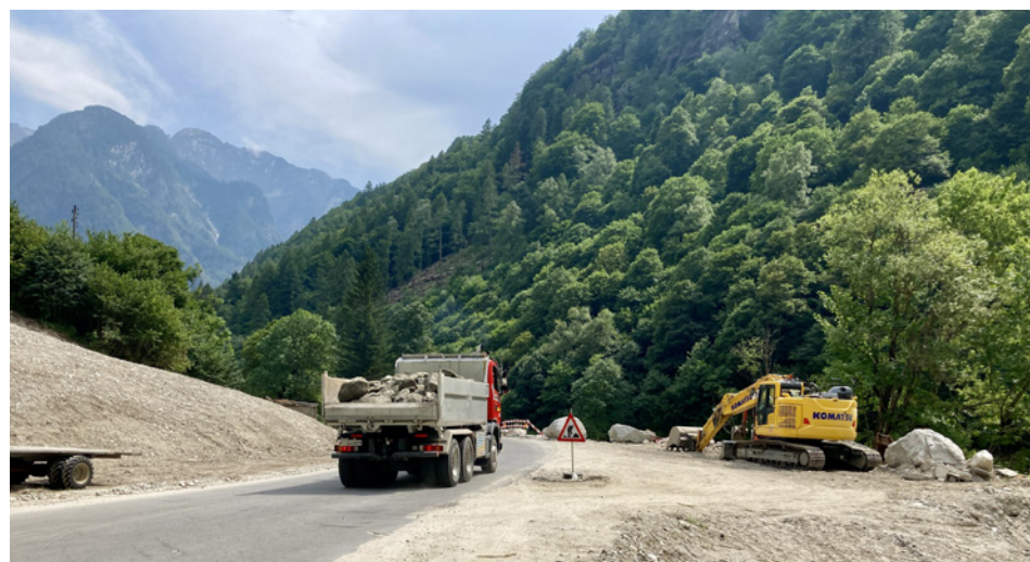
Enlèvement d'éboulis près de Prato Sornico
