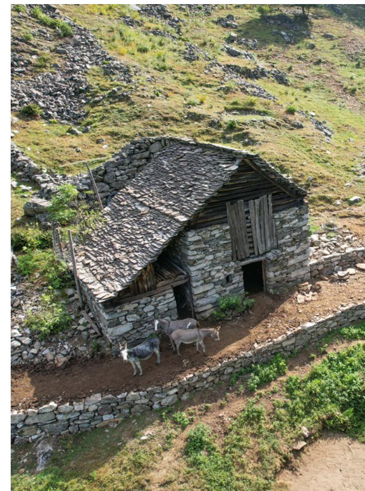
Die Cascine muss saniert werden
