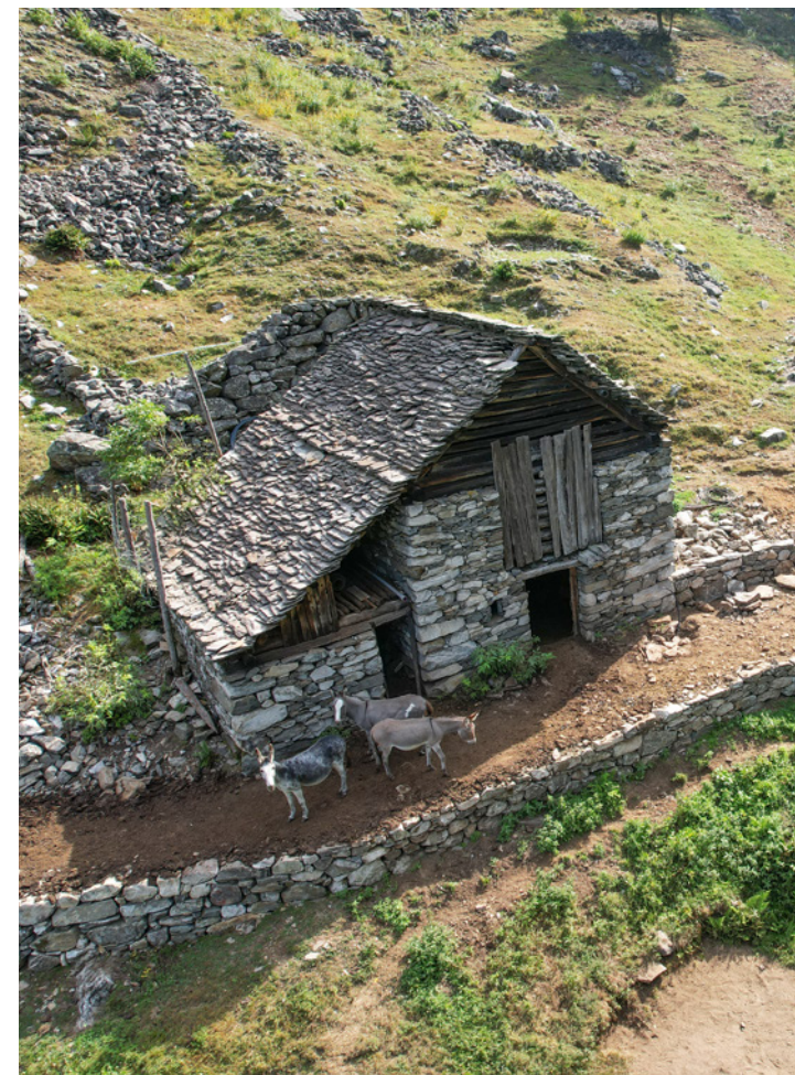
La cascina necessita di essere ristrutturata
